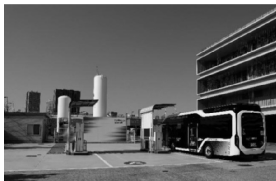
有明営業所内水素ステーション
